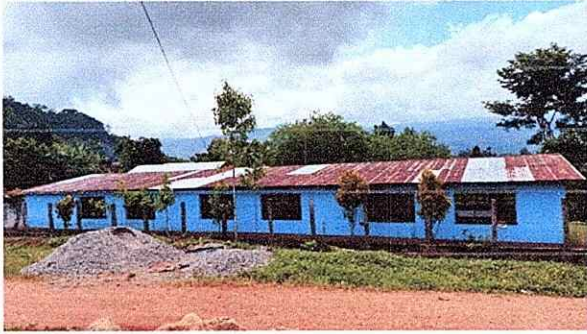
Foto1: ENTECHADO DE ESTABLECIMIENTO EN MAL ESTADO CON NECESIDAD DE CAMBIO MODULO 1
