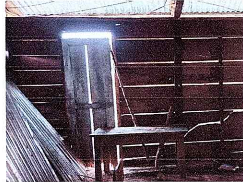
Foto 8: NECESIDAD DE CAMBIO DE CHAPA DE PUERTA POR MAL ESTADO MODULO 2
