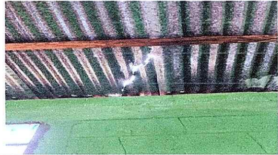
Foto 4: NECESIDAD DE CAMBIO DE ENTECHADO DE LAS AULAS EN MAL ESTADO MODULO 1
